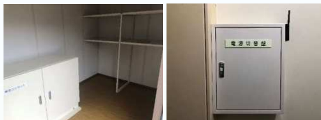
物置き内に制御盤
