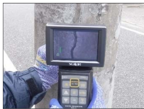
ひび割れ調査 (デジタル顕微鏡)
