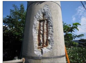
コンクリート剥離
